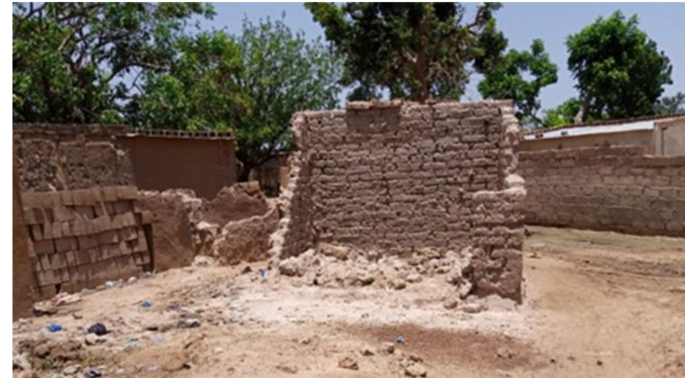
Une maison en banco détruite par les inondations et les pluies extrêmes à Ziniaré
